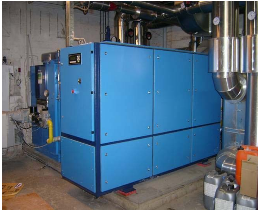
BHKW Modul und Kessel
